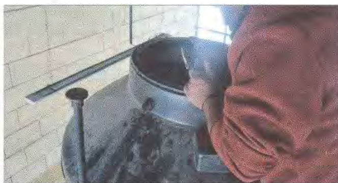
Foto 5: sustruccion de accesorios de deposito de agua
